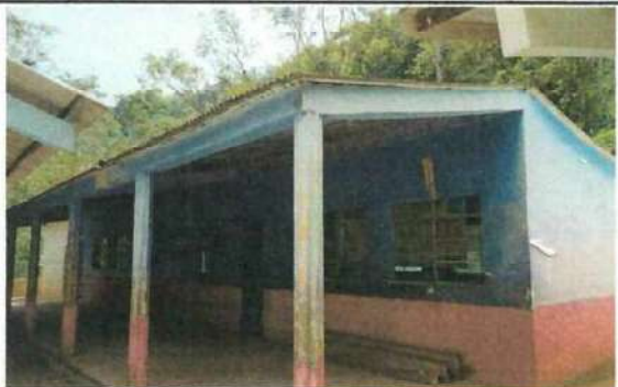
Foto1: Se observa la necesidad de elevar la pared portante del establecimiento educativo
