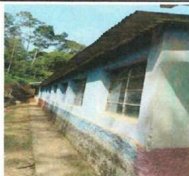
Foto 4: Se observa la necesidad de repellar y/o cernir paredes
